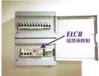
Typical DB (fuse box) 普通塑胶电路保险箱
